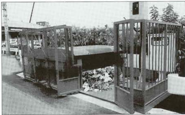
▲小松田川に設置されているごみ取りスクリーン
