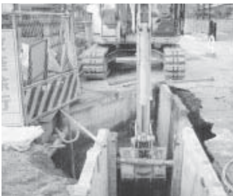
快適で衛生的な生活環境を整備する「下水道事業」
