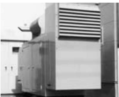
▲ 自家発電装置
