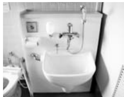
総合会館2階に設置
