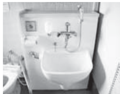
総合会館2階に設置
