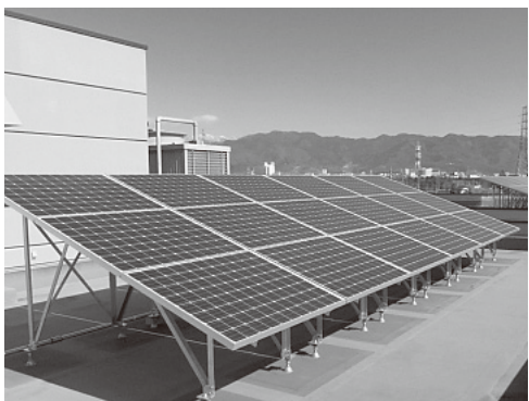
総合会館に設置された太陽光発電施設
