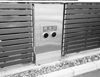
非常時に使用可能な貯水槽・消火栓
