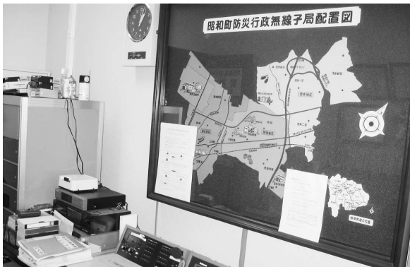
防災行政無線室
