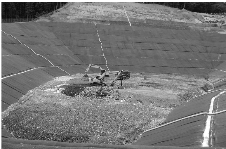
昭和町のゴミ焼却灰もここで処分
