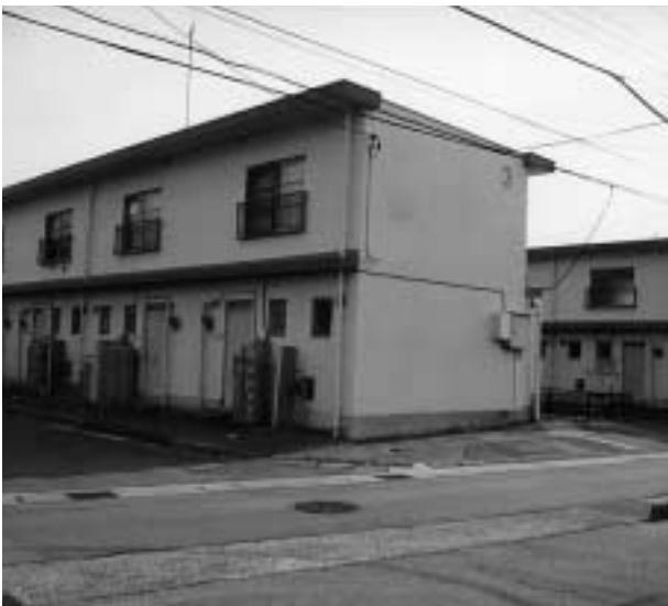
老朽化が著しく、立て替え予定の町営住宅
