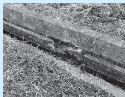
水路の壁にできたひび割れ
