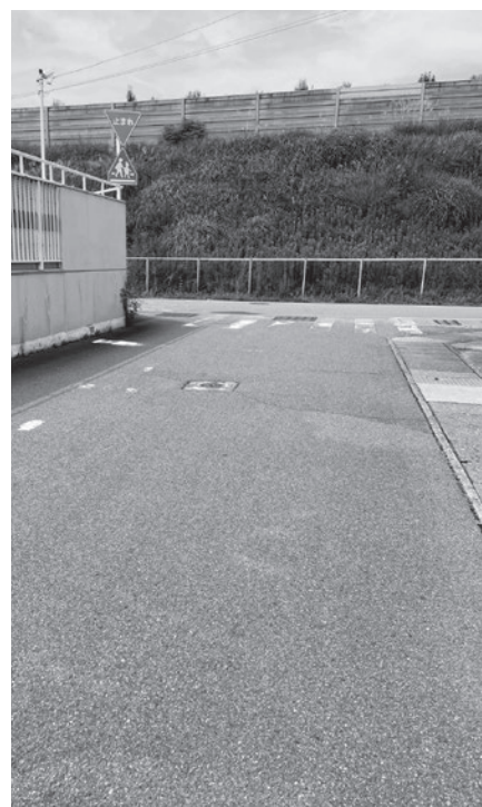
学校周辺の消えた路面標示
