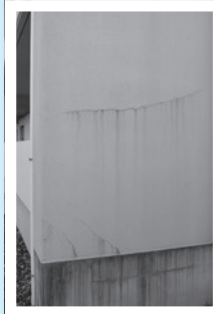
町営常永団地のひび割れ
