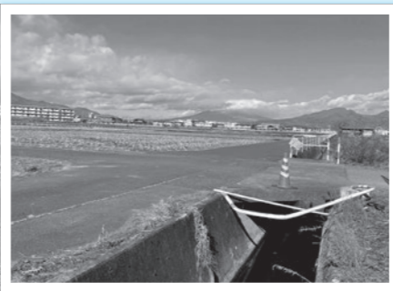
事故多発箇所
