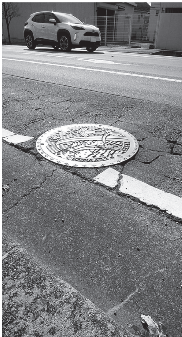
マンホール付近の段差
