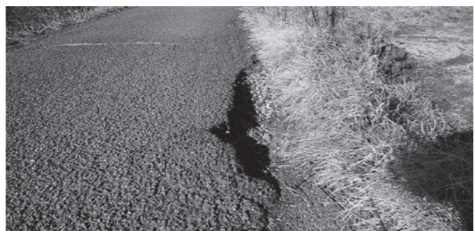
破損した路肩
